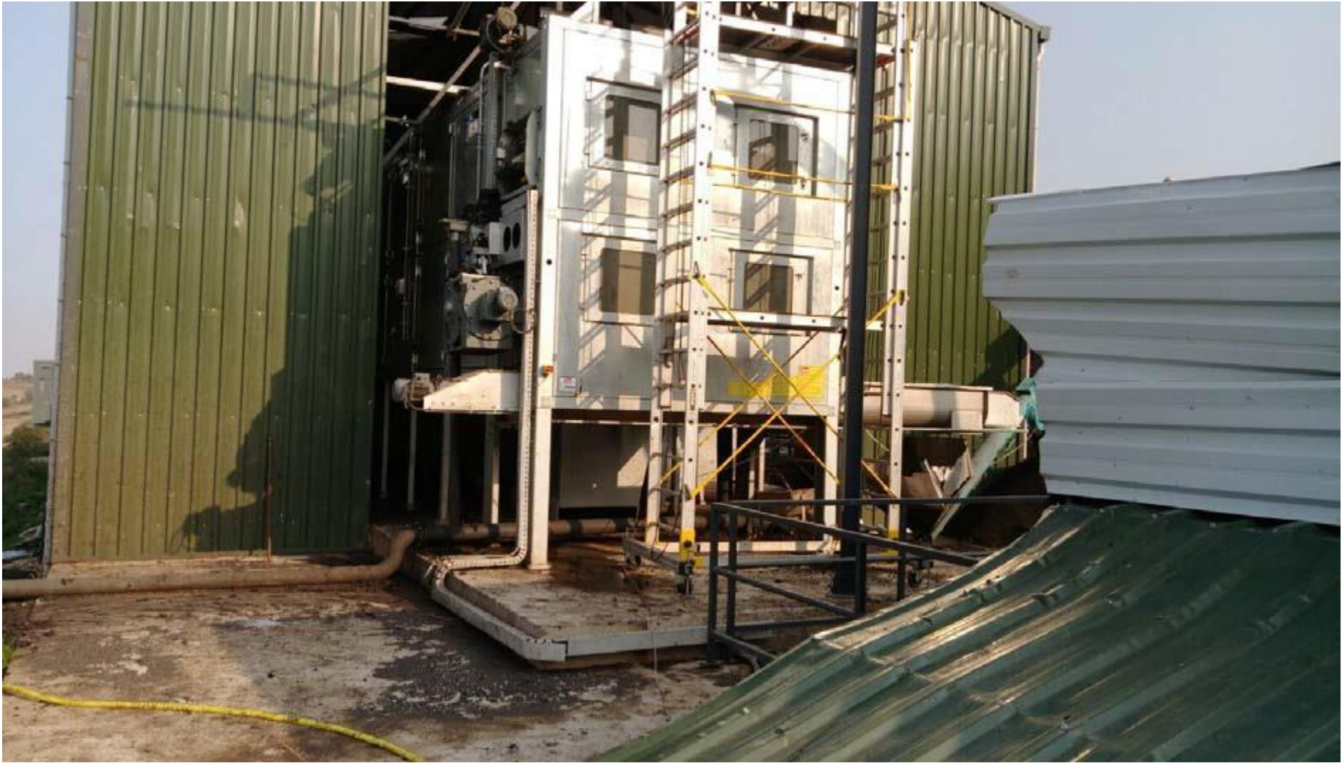
Kurutma Tesisi Çamur Girişİ
